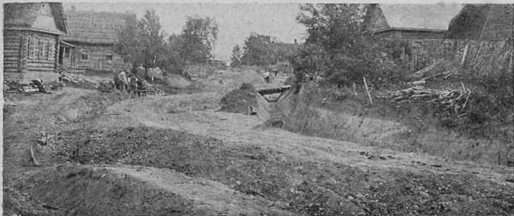
Пример неправильно устроенной деревенской дороги — откосы, резкие изломы в плане и т. д.
